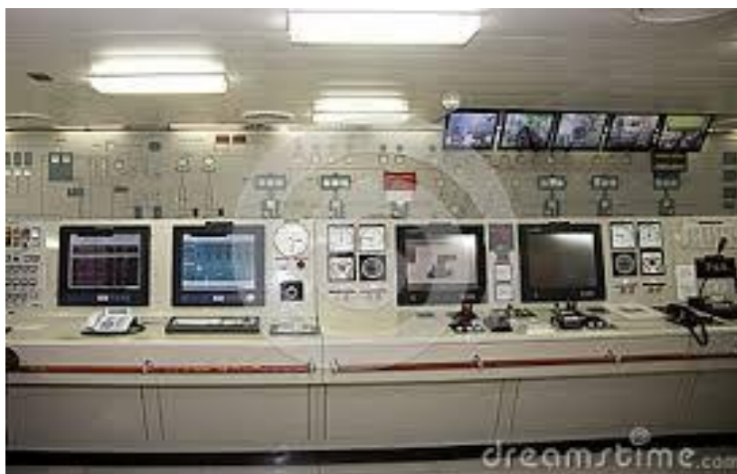
Εικόνα 1.2: Engine control room
