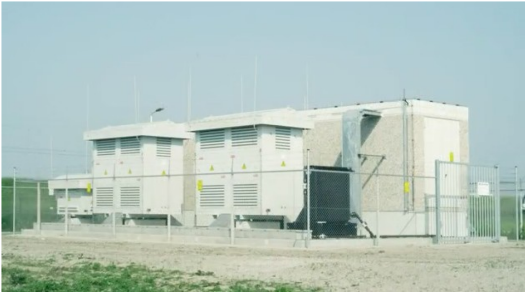
Εικόνα 2.1 Επίγειος υποσταθμός διανομής
