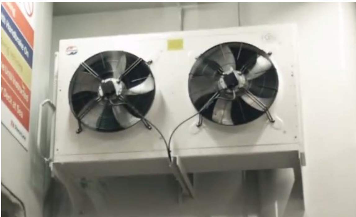
Εικόνα 2.2.3 Σύστημα αερισμού υποσταθμού πλοίου
