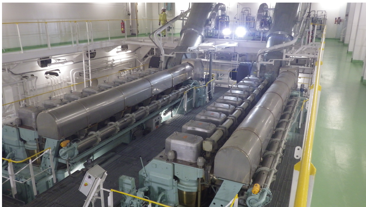
(Εδώ βλέπετε φωτογραφία από μηχανοστάσιο πλοίου τετράχρονης DFDE μηχανής σε σειρά)
