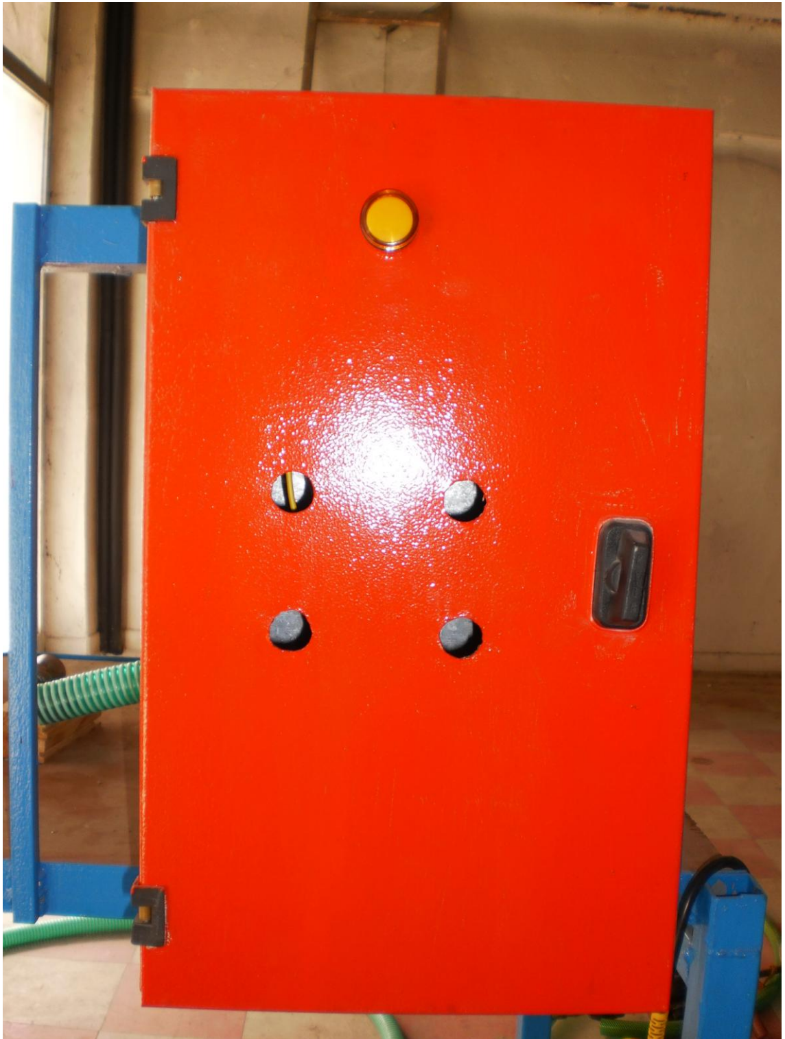
Ο πίνακας πριν την τοποθέτηση των μπουτόν και λυχνιών.
