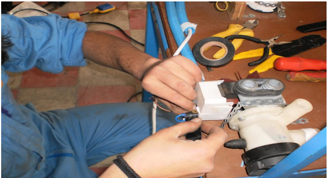
Ηλεκτρολογική σύνδεση αντλιών.
