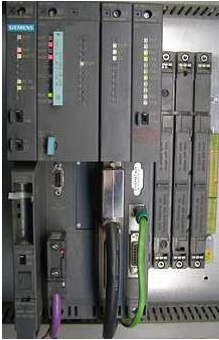
Εικόνα 2.3 Πίνακας PLC Siemens Simatic S7-416-3
