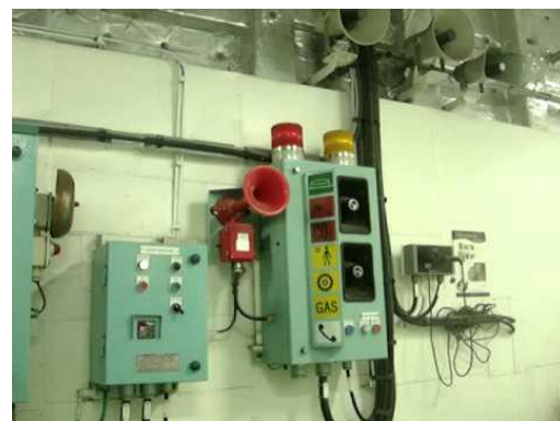
Εικόνα στ: Ο συναγερμός μηχανοστασίου
