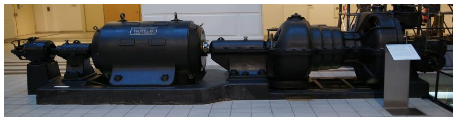
Εικόνα 13 : Ατμοστρόβιλος με γεννήτρια 250 Kw
