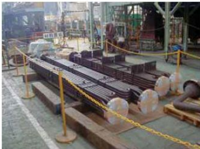
Εικόνα 28 : Αφυπερθερμαντήρας ελέγχου και παραγωγής
