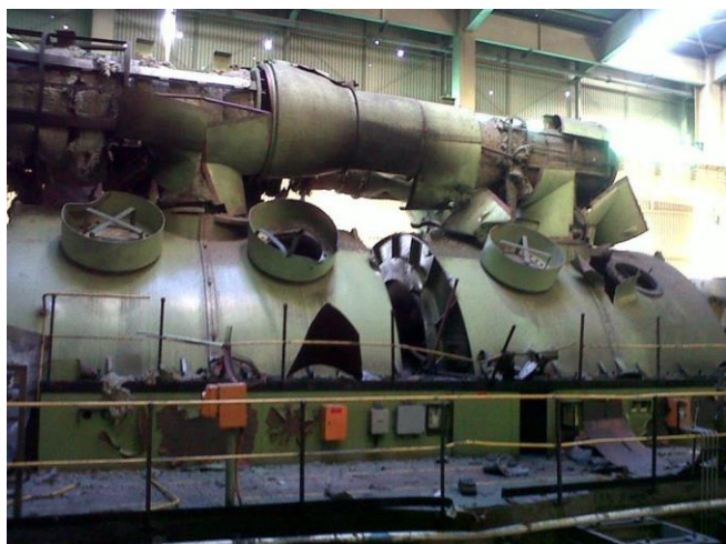
Εικόνα 54 : Εκτεταμένες ζημιές σε εγκατάσταση ατμοστροβίλου μετά απο υπερτάχυση
