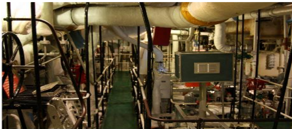
εικόνα 1.11 Τμήμα του Λεβητοστασίου του αγγλικού πολεμικού πλοίου Μπέλφαστ
