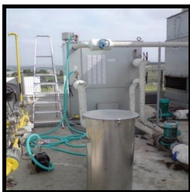
36 Εικόνα 4.5.2α : Χημικός καθαρισμός πλακοειδή εναλλάκτη θερμότητας .
