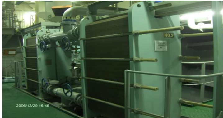
20 Εικόνα: εγκατάσταση πλακοειδή εναλλάκτη θερμότητας F.W CENTRAL COOLERS.
