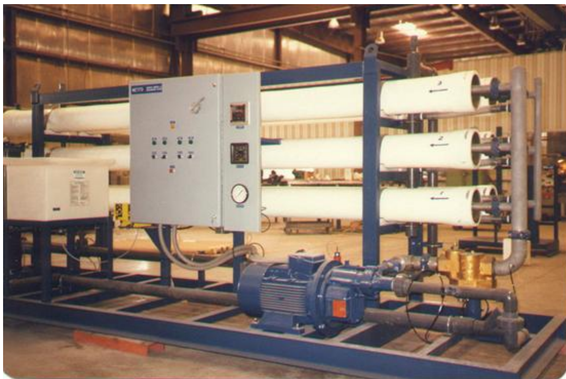
Εικόνα 8: Μονάδα αντίστροφης όσμωσης Υφάλμυρου νερού, 400 m 3 /day, Riyand, K.S.A
