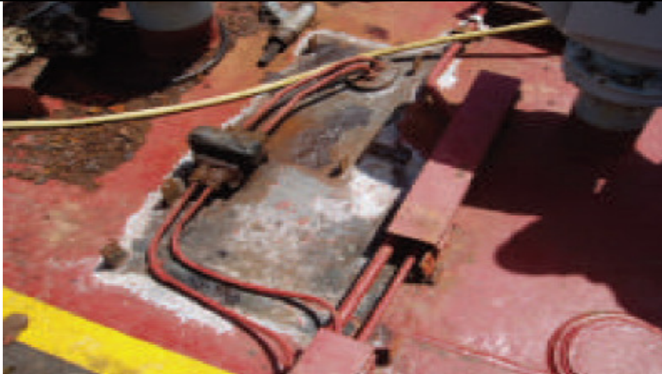
Εικόνα 4-3: Ένα άλλο παράδειγμα σοβαρής διάβρωσης σε μη προσβάσιμες περιοχές κάτω από τους διαδρόμους στο ανώτερο κατάστρωμα.
