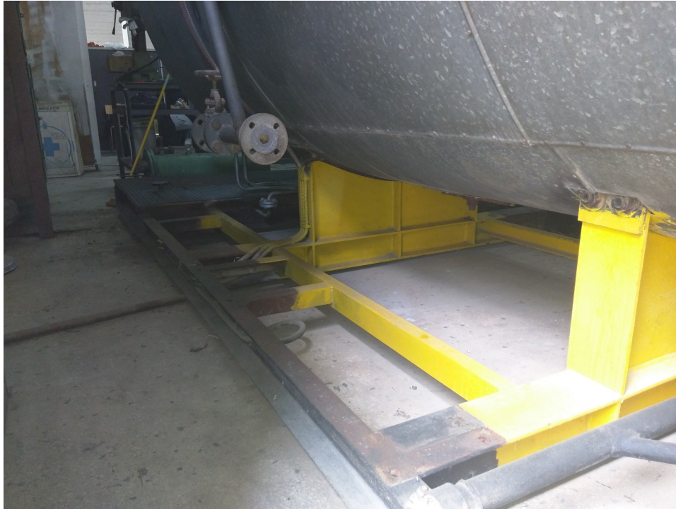
Ατμολέβητας «Μασίνα» Χρυσολούρης Πριν τον Καθαρισμό
