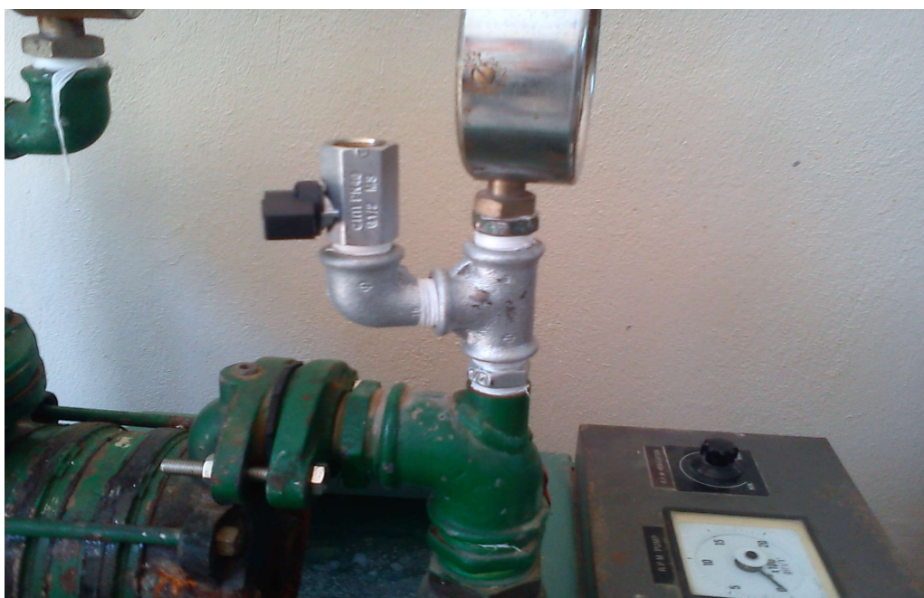
Εικόνα 25: Επιστόμιο πλήρωσης αντλίας
