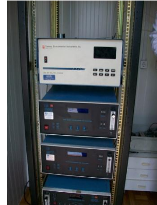
Εικόνα δεξιά: Όργανα καταγραφής αερίων ρύπων στο Σταθμό Παρακολούθησης Αερίων Ρύπων του ΟΛΠ ΑΕ.
