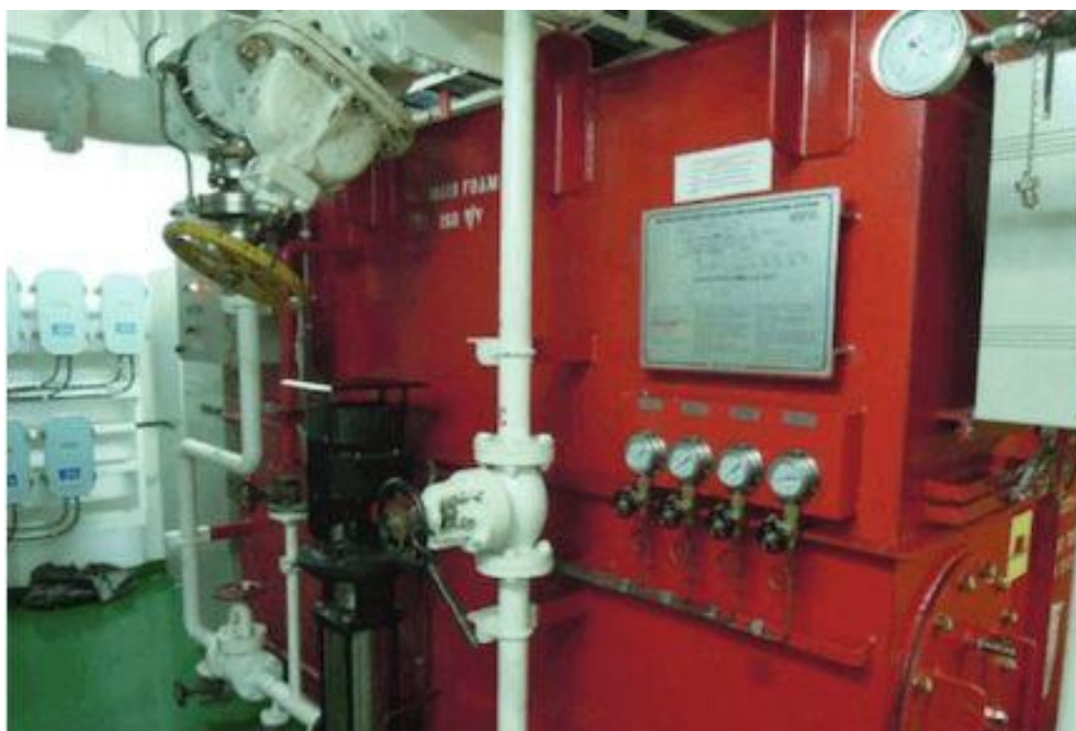
Εικόνα 7: Δεξαμενή αφρογόνου υλικού
