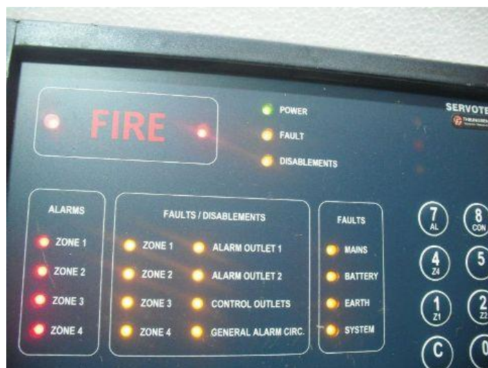
Εικόνα 1: Πίνακας ελέγχου και αναγγελίας πυρκαγιάς
