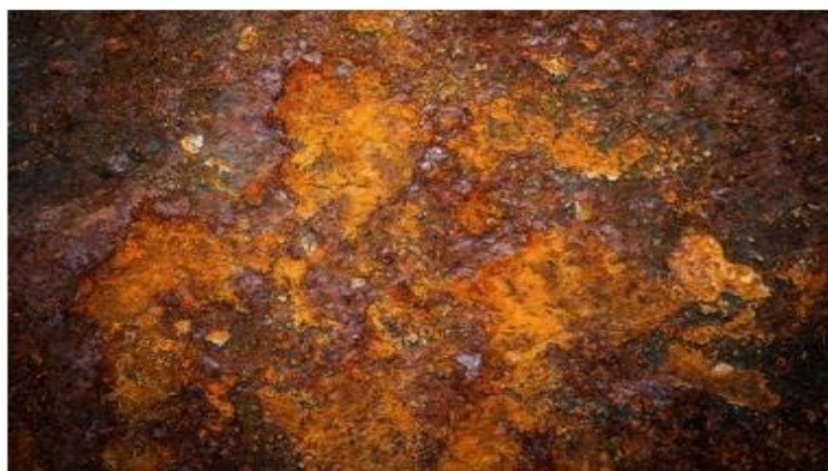
Εικόνα 14. Διάβρωση πυθμένα δεξαμενής έρματος (Πηγή: Obanijesu, 2009)
