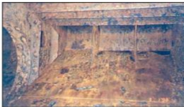
Εικόνα15. Κακή κατάσταση δεξαμενής έρματος, μετά από 13 έτη λειτουργίας
