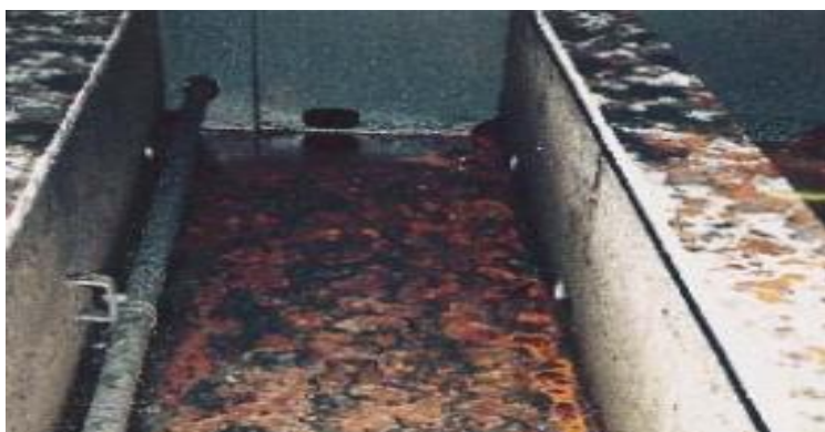
Εικόνα 13. Μικροβιακή διάβρωση σε δεξαμενή έρματος
