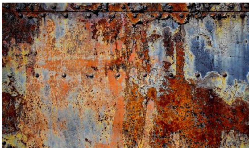
Εικόνα 7. Διάβρωση χάλυβα (Πηγή: www.sgs.com )
