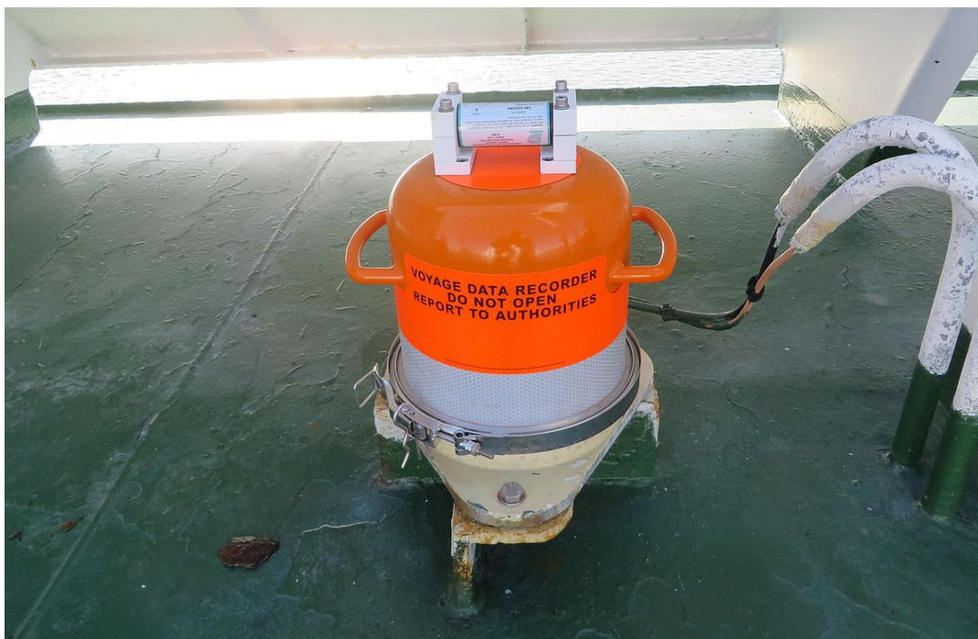
Εικόνα 4: Καταγραφέας Δεδομένων Ταξιδιού εγκατεστημένος πλησίον της γέφυρας και εξωτερικά
