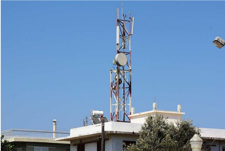
Κεραία ραδιο-τηλεοπτικού σταθμού
