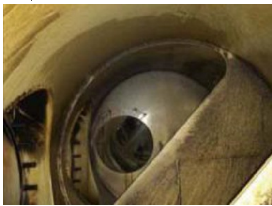
Εικόνα 17: Μονάδα κυλίνδρου 8 παρακείμενη στο θάλαμο εισαγωγής αέρα
