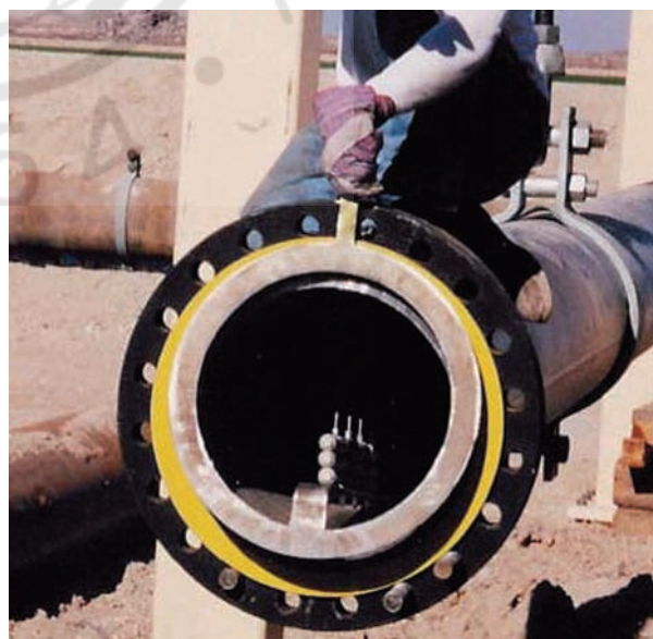
Σχ. 7.1δ. Καθοδική προστασία σωλήνα με θυσιαζόμενες ανόδους για σωλήνα ελικοειδούς ραφής.
