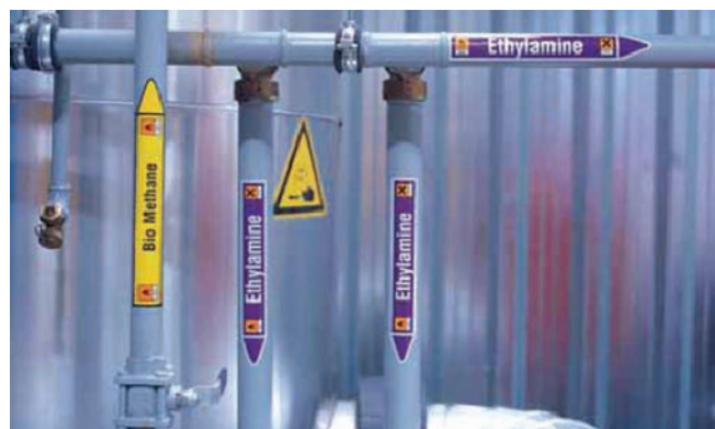
Σχ. 7.1n. Σήμανση σωληνώσεων.
