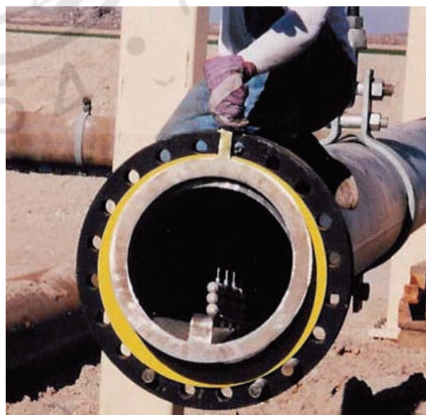
Σχ. 7.1δ. Καθοδική προστασία σωλήνα με θυσιαζόμενες ανόδους για σωλήνα ελικοειδούς ραφής.
