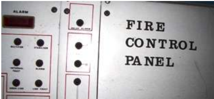
Εικόνα πίνακας ελεγχου πυρκαγιάς
