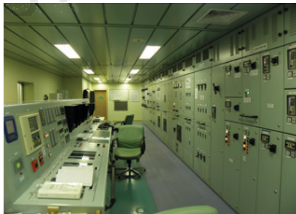
Σχ. 7.1β. Δωμάτιο ελέγχου και αυτοματισμών.
