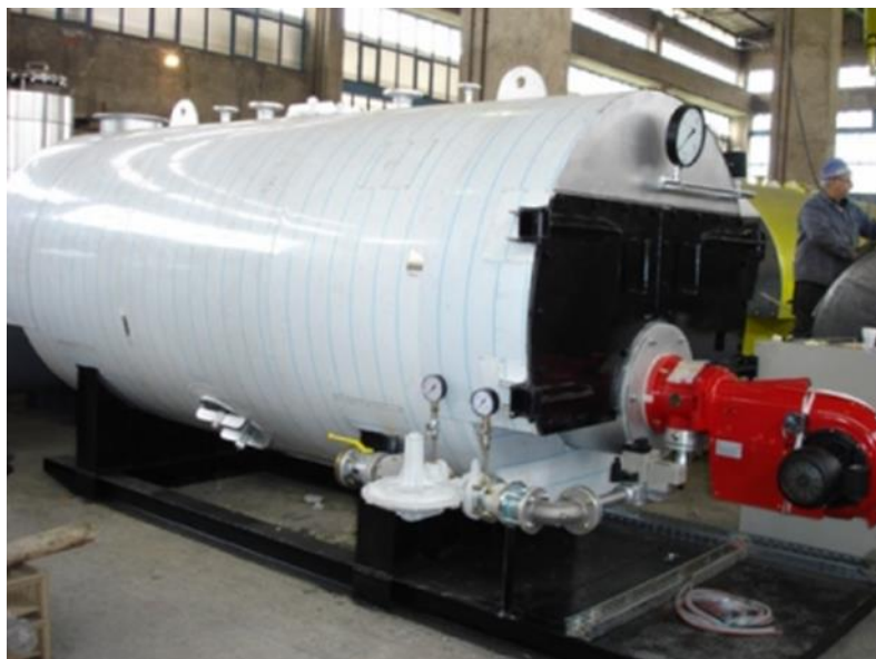
Εικόνα 2: Τυπικός βιομηχανικός ατμολέβητας
