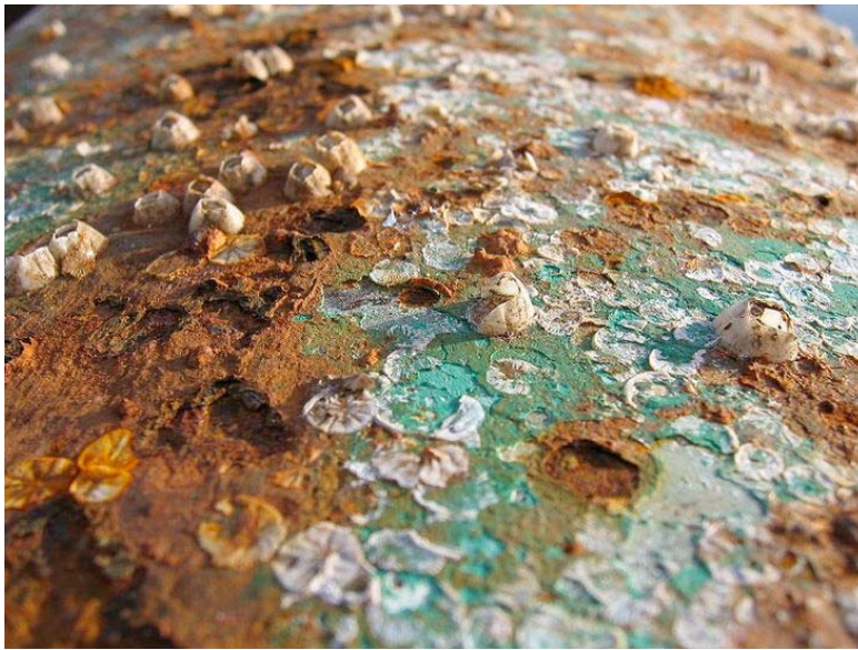
Εικόνα 2: Διάβρωση στο μεταλλικό κύτος του πλοίου
