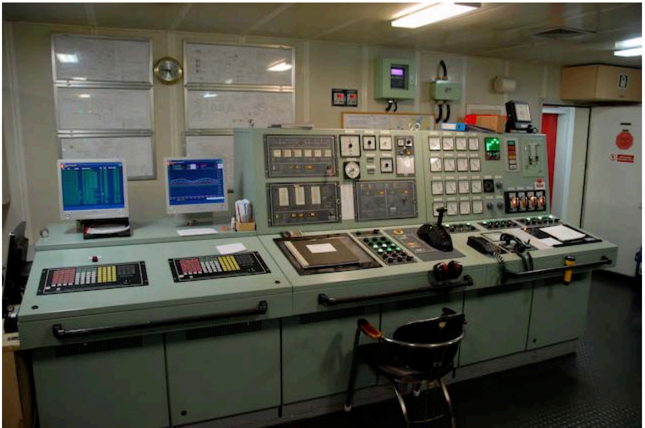
Εικόνα 1. Κέντρο έλεγχου Μηχανοστασίου ( Control Room)
