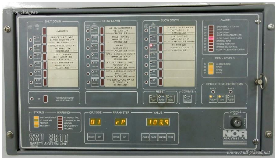
Εικόνα 4.3 Σύστημα αυτόματου ελέγχου Autochief
