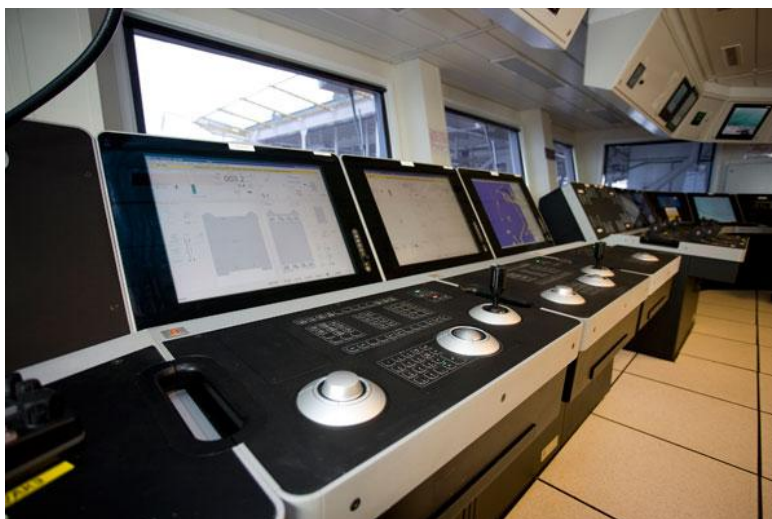
Εικόνα 2.16 Κέντρο ελέγχου με τρεις θέσεις εργασίας
