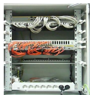
Εικόνα 4.7 Εσωτερική όψη ενός NDU.
