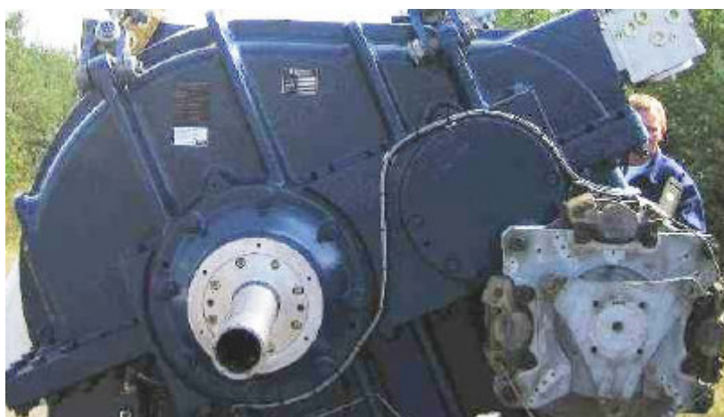
κιβώτιο ταχυτήτων του κύριου άξονα και του συστήματος φρένων.
