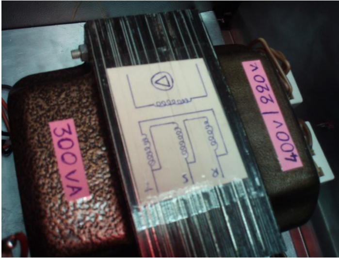
Εικόνα 5.4 Ο μετασχηματιστής της τριφασικής γέφυρας .
