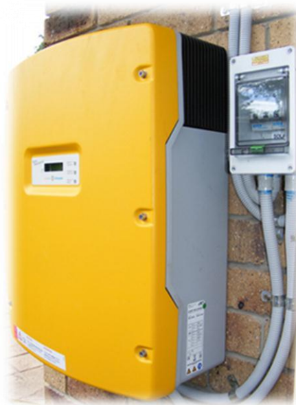
Εικόνα 0.3.2.5.1 – Inverter ηλιακού συστήματος ενέργειας.
