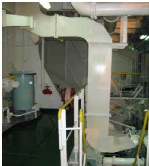
Εικόνα 2.6 Αγωγός εξαερισμού μηχανοστασίου
