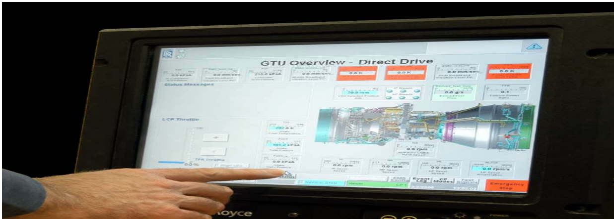
Εικόνα 1.3.3. Σύστημα ελέγχου του αεροστροβίλου MT30
