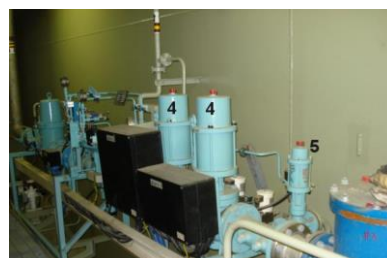
Εικόνα 3.4: Μονάδα ρύθμισης φυσικού αερίου από άλλη μεριά
