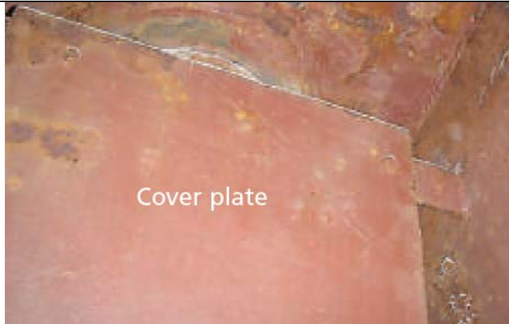
Εικόνα 4-14: Πλάκα επικαλύψεως για την προστασία των σωλήνων.
