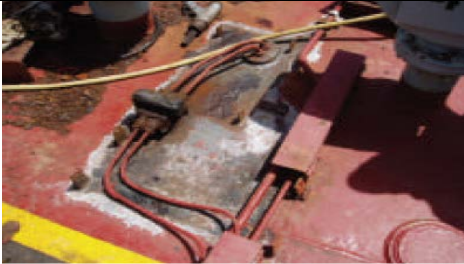
Εικόνα 4-3: Ένα άλλο παράδειγμα σοβαρής διάβρωσης σε μη προσβάσιμες περιοχές κάτω από τους διαδρόμους στο ανώτερο κατάστρωμα.
