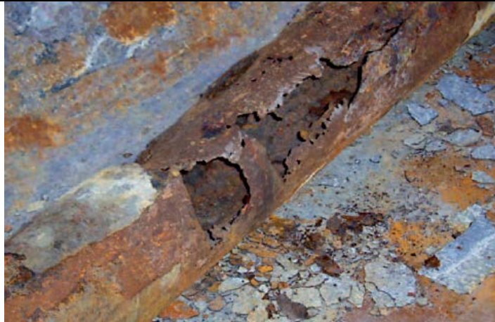
Εικόνα 2-1: Κατεστραμμένη Σωλήνα αέρα
