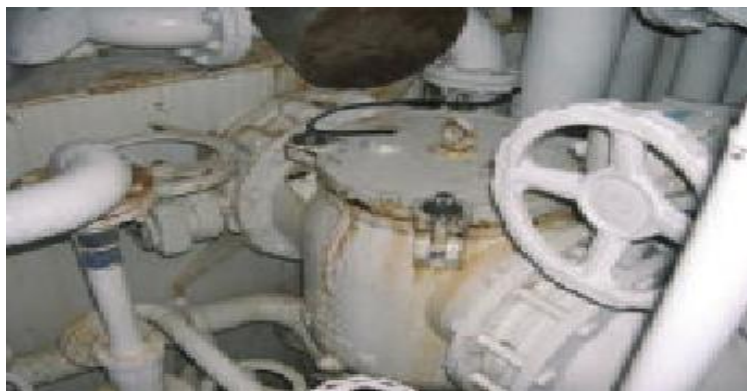
Εικ.2.4.1: Φίλτρο εισαγωγής θαλασσινού νερού, επιστόμια και δίκτυο σωληνώσεων στον χώρο του μηχανοστασίου.
