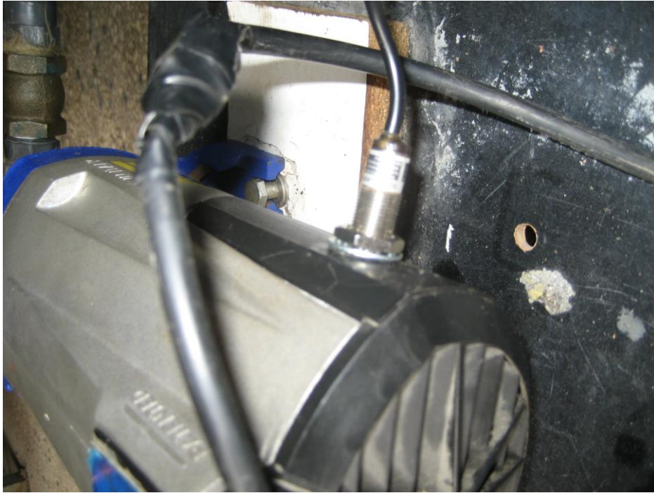
Εικόνα 3.17 Το νέο pickup τοποθετημένο στην αντλία Όλοι οι σύνδεσμοι και οι βάνες λύθηκαν και καθαριστήκαν.
