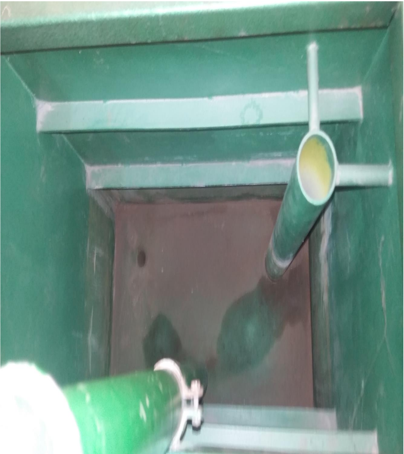
Εικόνα 2.1.3.β: Δεξαμενή κατάθλιψης
