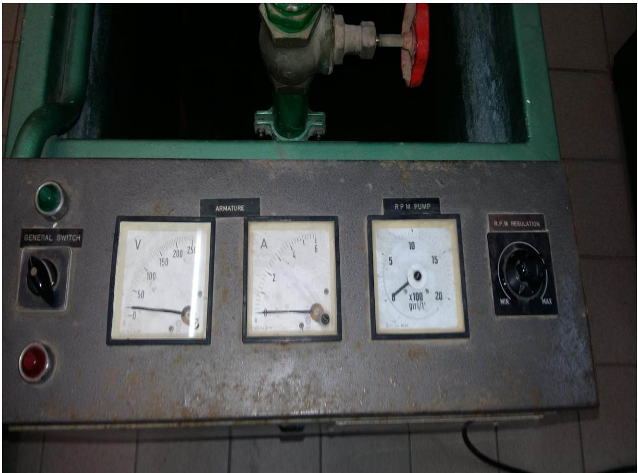
Εικόνα 2.1.2γ: Πίνακας ελέγχου
