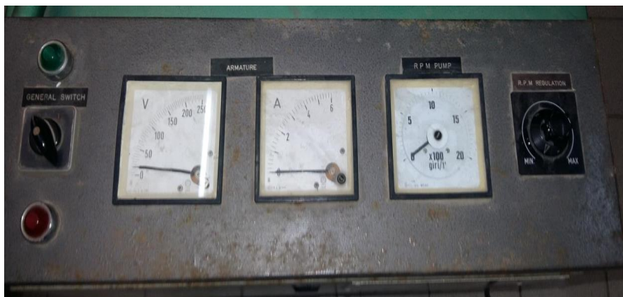
Εικόνα 4.1.δ Πίνακας ελέγχου εγκατάστασης
