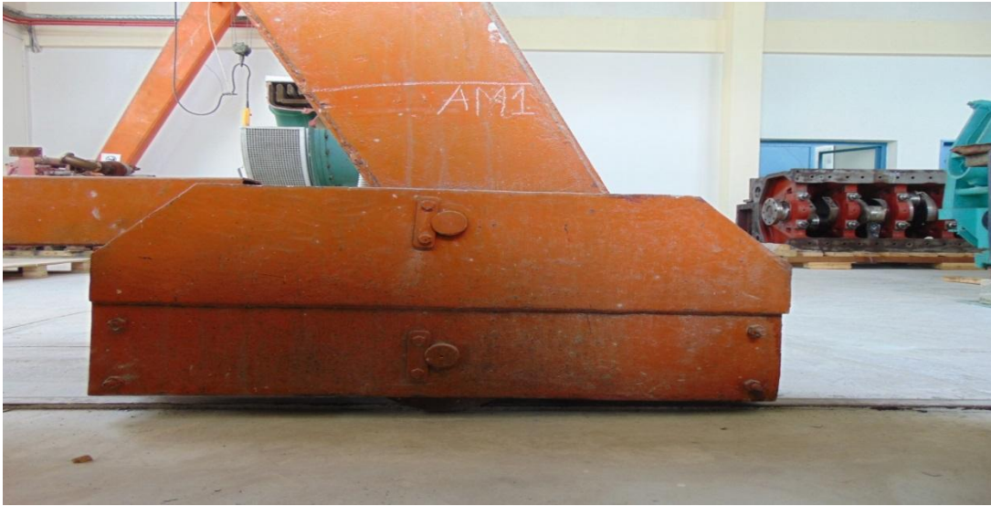
Εικόνα 27 Πλάγια όψη της εξωτερικής πλευράς της γερανογέφυρας. Διακρίνονται: ο πείρος της κινητήριας τροχαλίας και ο πείρος σύνδεσης της δοκού και η συγκόλληση των μερών της γερανογέφυρας. Η βάση της μπούμας είναι λοξή λόγω υπερφόρτωσης ή κατασκευαστικού λάθους.
