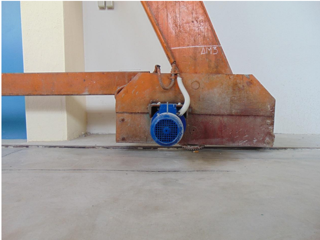
Εικόνα 39 Αριστερή πλάγια όψη της δεξιάς πλευράς της γερανογέφυρας. Διακρίνεται ο ηλεκτροκινητήρας με την καλωδίωσή του και η οδόντωση του τροχού. Η βάση είναι λοξή λόγω υπερφόρτωσης ή κατασκευαστικού λάθους.
