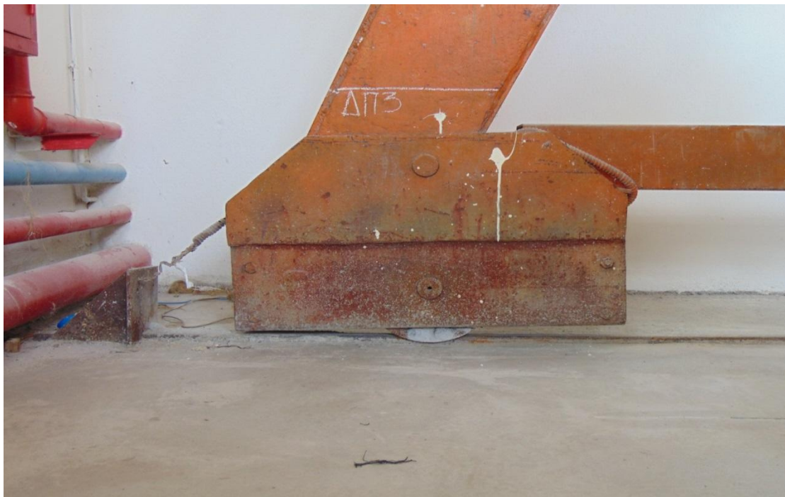
Εικόνα 42 Αριστερή πίσω πλάγια όψη της γερανογέφυρας. Διακρίνεται ο πίσω τροχός και το φρένο στο τέλος της σιδηροτροχιάς. Η βάση είναι λοξή λόγω υπερφόρτωσης ή κατασκευαστικού λάθους.
