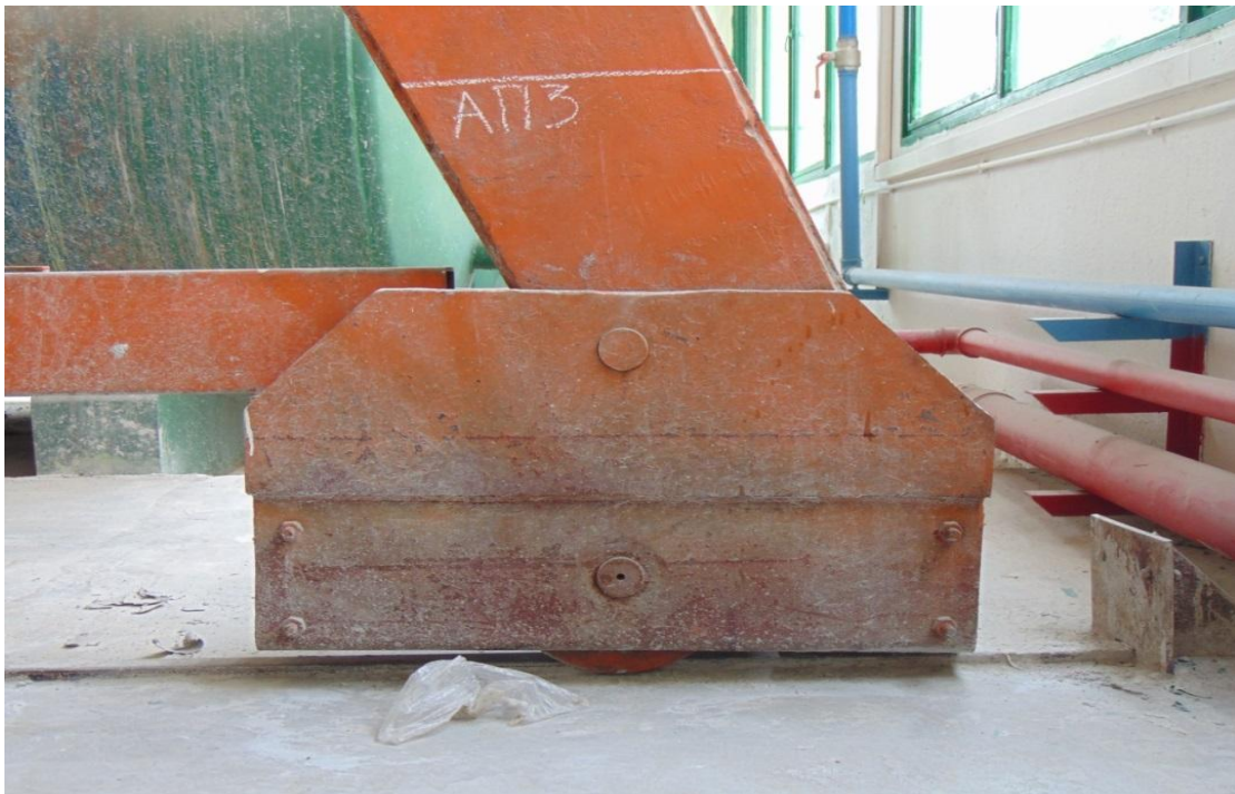
Εικόνα 34 Δεξιά πλάγια όψη της πίσω πλευράς της γερανογέφυρας. Φαίνονται ο πείρος του τροχού και ο πείρος σύνδεσης της μπούμας με τη βάση. Η βάση είναι λοξή λόγω υπερφόρτωσης ή κατασκευαστικού λάθους.
