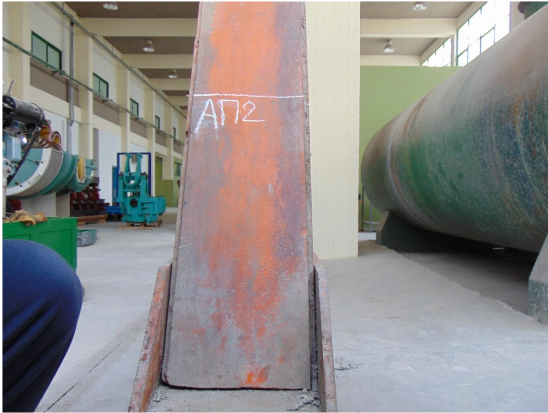
Εικόνα 33 Πίσω όψη γερανογέφυρας. Φαίνεται η βάση της μπούμας στήριξης κατασκευή είναι συγκολλητή ενώ η σύνδεση της μπούμας με τη βάση γίνεται με πείρο.
