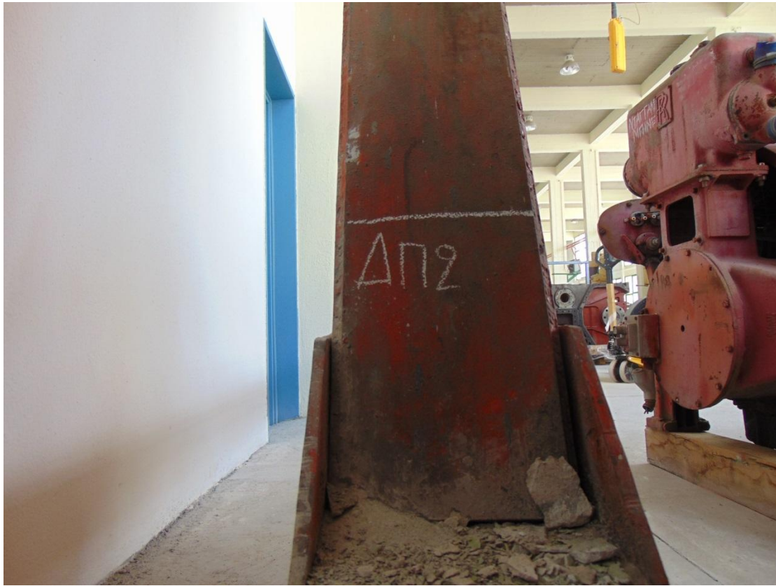
Εικόνα 41 Πίσω όψη της δεξιάς πλευράς της γερανογέφυρας. Η μπούμα είναι συγκολλητή ενώ η σύνδεσή της με τη βάση γίνεται με πείρο. Είναι εμφανές ότι τα μέταλλα έχουν υποστεί διάβρωση.
