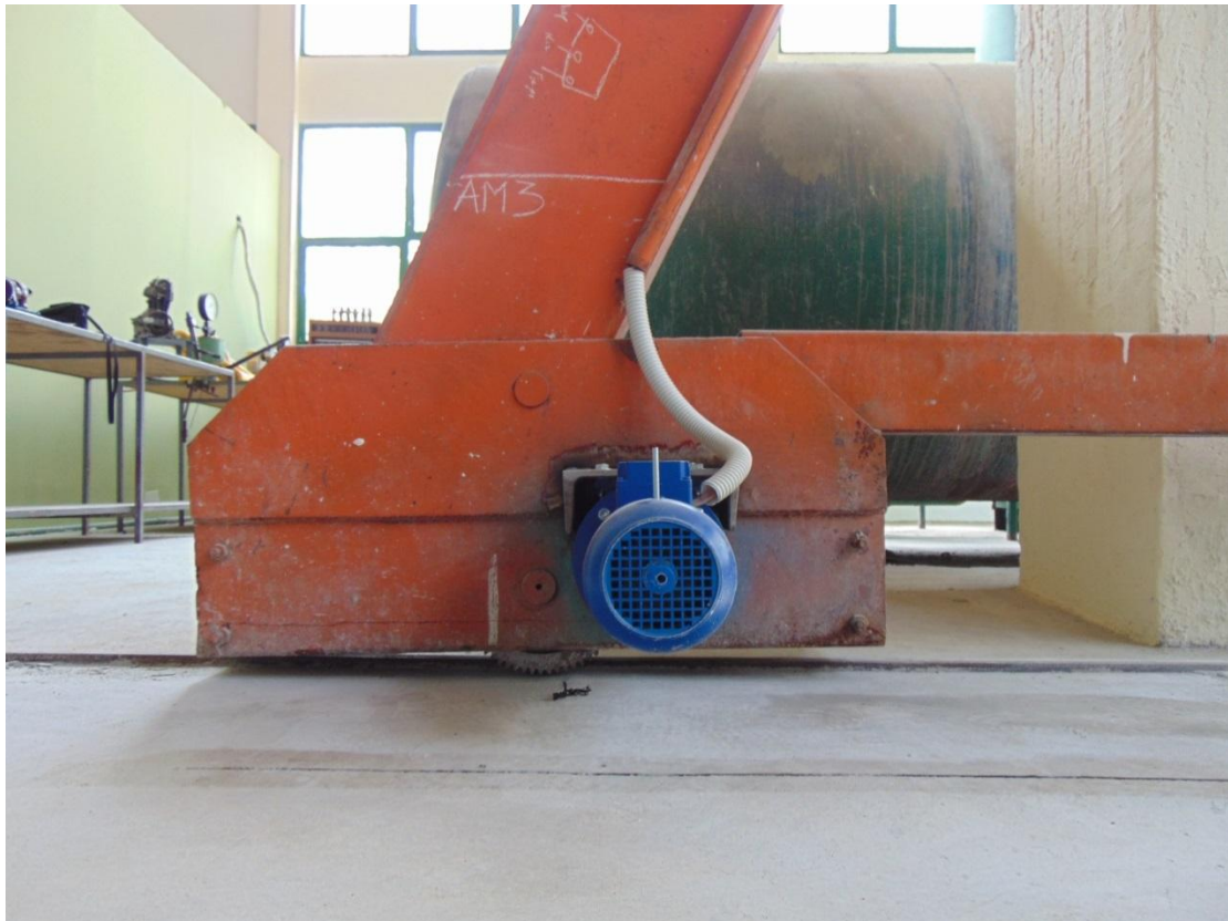
Εικόνα 29 Δεξιά πλάγια όψη του εμπρόσθιου κινητήριου τμήματος της γερανογέφυρας. Φαίνεται ο ηλεκτροκινητήρας και η καλωδίωσή του. Η βάση είναι λοξή λόγω υπερφόρτωσης ή κατασκευαστικού λάθους.
