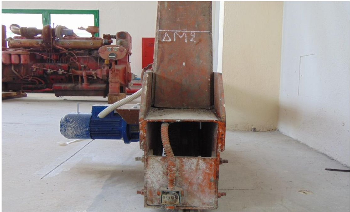
Εικόνα 38 Πρόοψη της δεξιάς πλευράς της γερανογέφυρας. Διακρίνεται ο ηλεκτροκινητήρας με την καλωδίωσή του. Η μπούμα είναι συγκολλητή ενώ η σύνδεση της με τη βάση γίνεται με πείρο.
