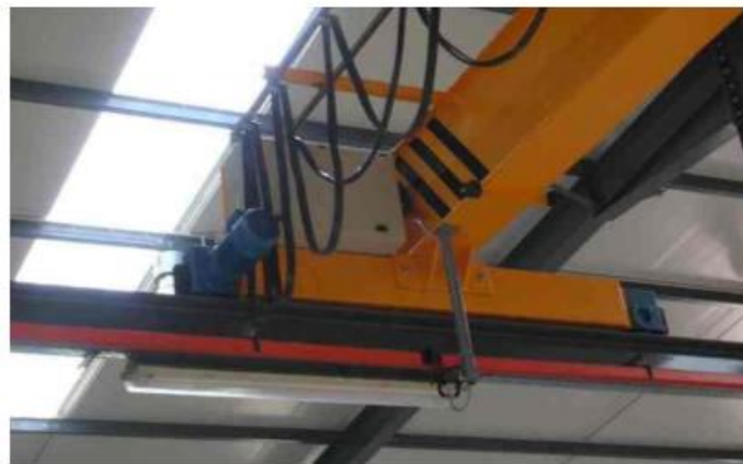
Εικόνα 3 Ηλεκτροκινητήρας σε πλευρά της γέφυρας
