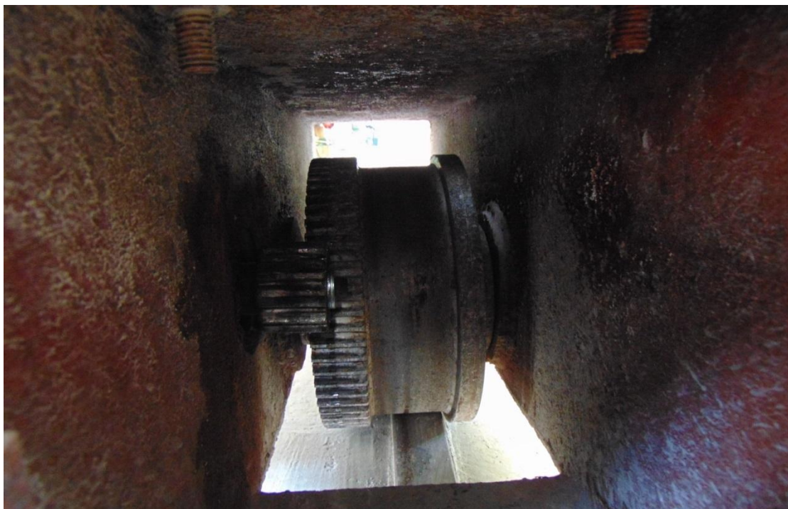
Εικόνα 30 Κινητήριο και κινούμενο γρανάτζι μετάδοσης κίνησης στον τροχό της γερανογέφυρας με την οδόντωσή τους. Διακρίνεται και τμήμα της σιδηροτροχιάς.
