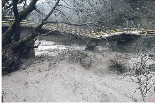
Εικόνα 1: Κατεστραμμένο φράγμα στη γέφυρα της Άρτας λόγω πλημμύρας (Πηγή: www.protothema.gr ).
