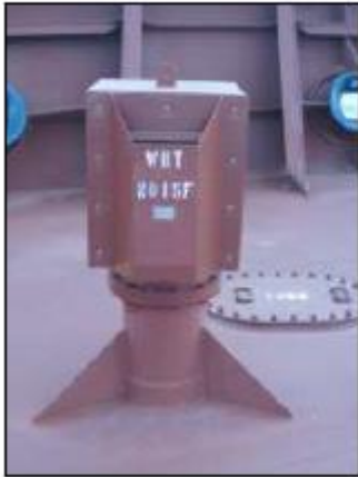
Εικόνα 37 Ball Valve Vent Head (αεραγωγός δεξαμενών έρματος)
