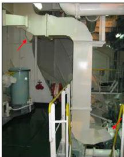
Εικόνα 43 Αγωγός εξαερισμού μηχανοστασίου
