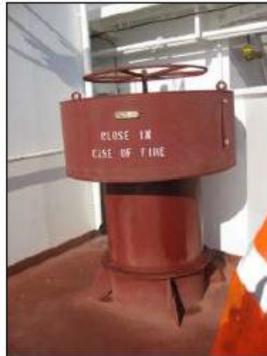
Εικόνα 38 Ανεμιστήρας τύπου μανιτάρι για αερισμό του χώρου πηδαλιού
