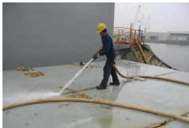
Εικόνα 33. Έλεγχος διαρροών με χρήση hose testing (Πηγή: https://maritimecyprus.files.wordpress.com/2017/09/risk_focus_-_hatch_covers.pdf )
