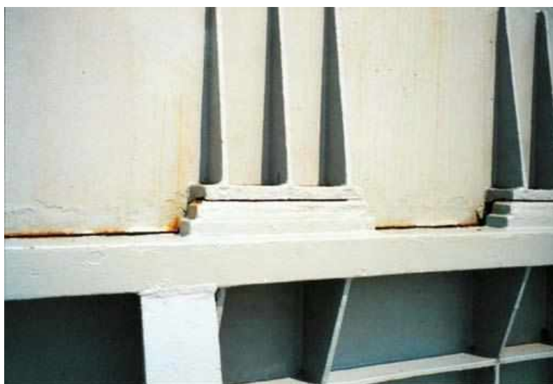
Εικόνα 31. Φθαρμένα steel-to-steel σημεία επαφής σε hatch cover και landing pads (Πηγή: https://www.standard-club.com/media/58123/MGHatchCoverMaintenance.pdf )
