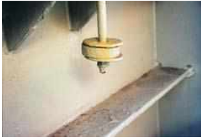
Εικόνα 27. Ανεπαρκώς συντηρημένο track way ενός hatch wheel (Πηγή: https://www.standard-club.com/media/58123/MGHatchCoverMaintenance.pdf )
