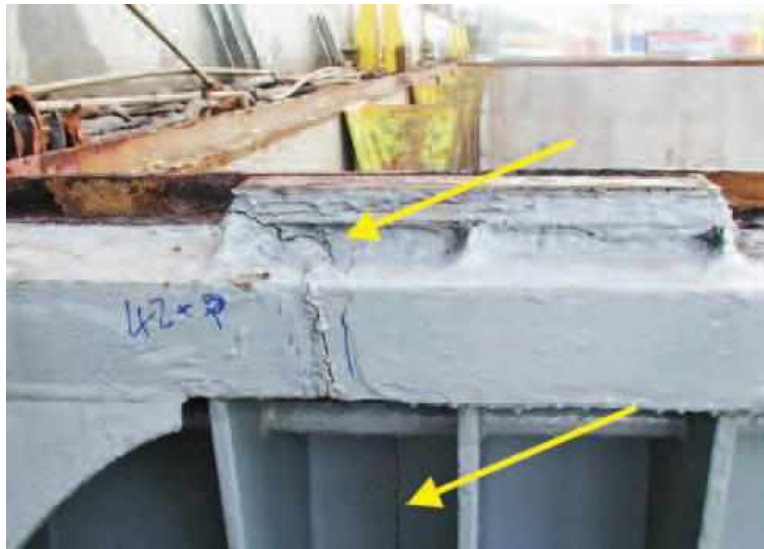
Εικόνα 23. Αναπτυσσόμενη ρωγμή από το landing pad μέχρι τα προεξέχοντα άκρα της υδρορροής του πλοίου (Πηγή: https://www.ukpandi.com/news-and-resources/bulletins/2017/risk-focus-hatch-covers/ )
