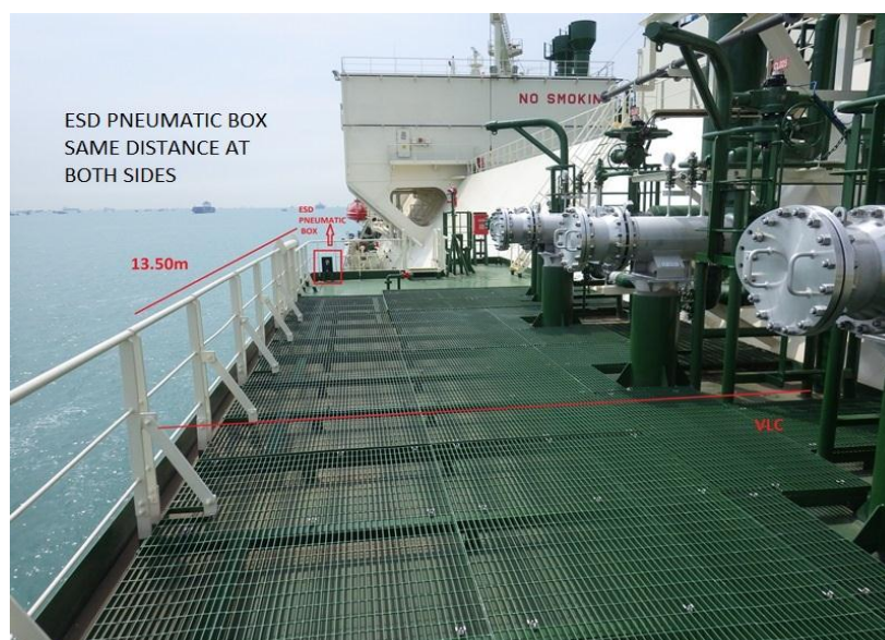
(Εικ.Νο28, Χώρος των manifolds)
