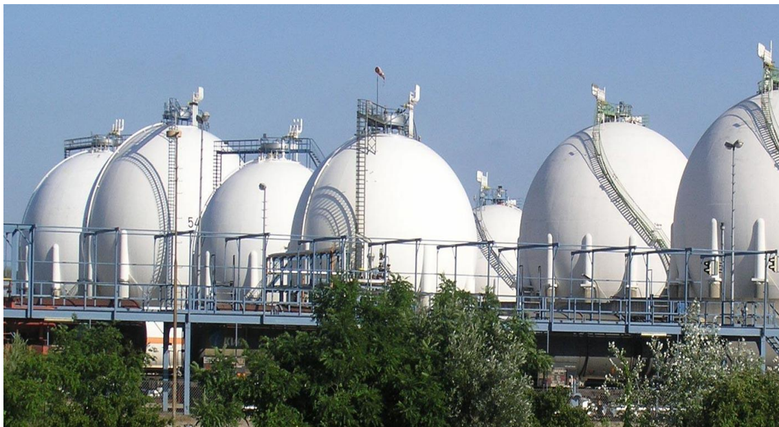
Δεξαμενές αποθήκευσης φυσικού αερίου.
