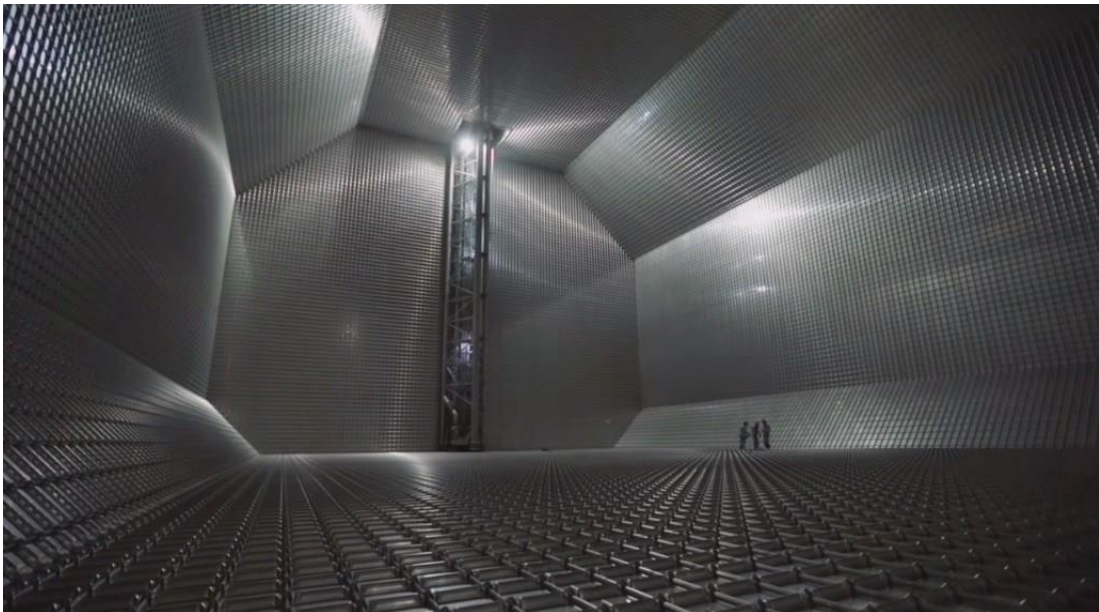
Ο εσωτερικός χώρος μιας δεξαμενής τύπου Mark III
