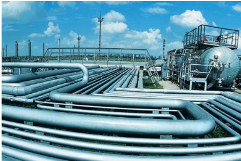
Εικόνα 3: Εγκαταστάσεις φυσικού αερίου
