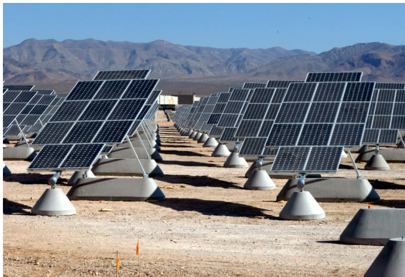
Εικόνα 5: Ηλιακή ενέργεια - φωτοβολταϊκό πάρκο
