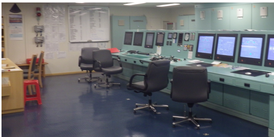
Εικόνα Νο.3 – Εσωτερικό Δωματίου Ελέγχου Μηχανής – Control Room
