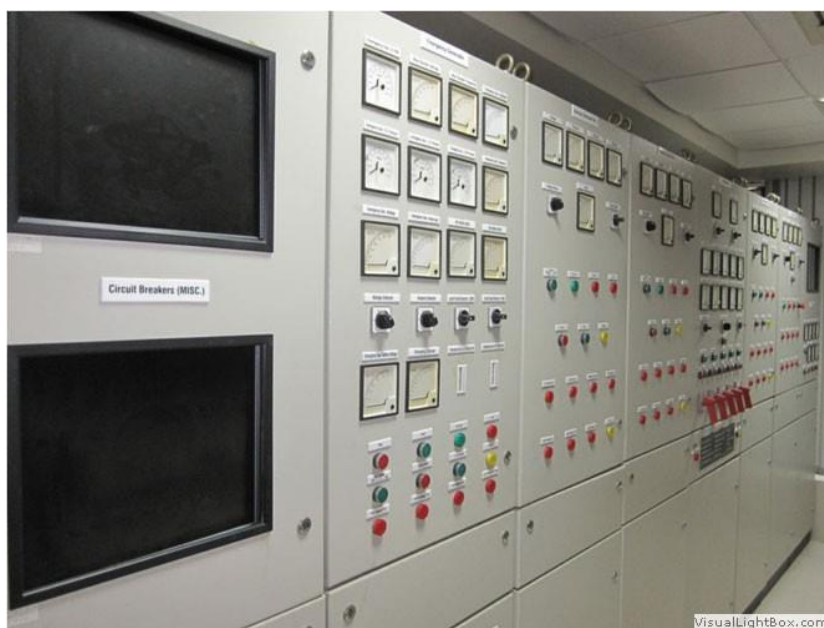
Εικόνα Νο.4 – Εσωτερικό Δωματίου Ελέγχου Μηχανής – Control Room και Πίνακες Ελέγχου
