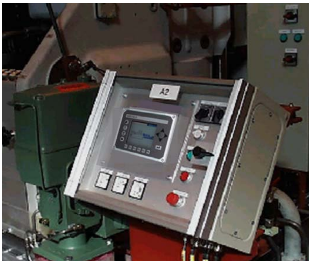
Σχήμα 4.12: Παράδειγμα τοπικού πίνακα ελέγχου στη μηχανή διπλού καυσίμου[20]
