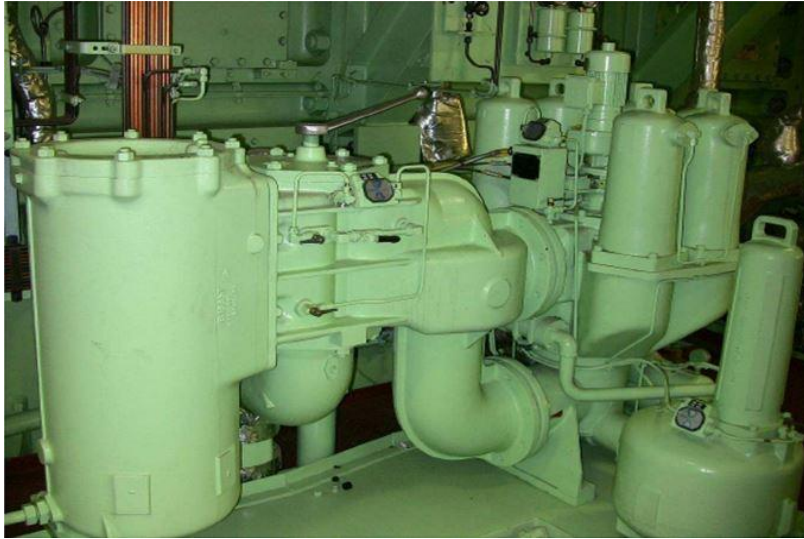
Εικόνα 25: Μονάδα αυτοκαθαριζόμενων φίλτρων λαδιού (δεξιά) και το By-Pass (αριστερά).
